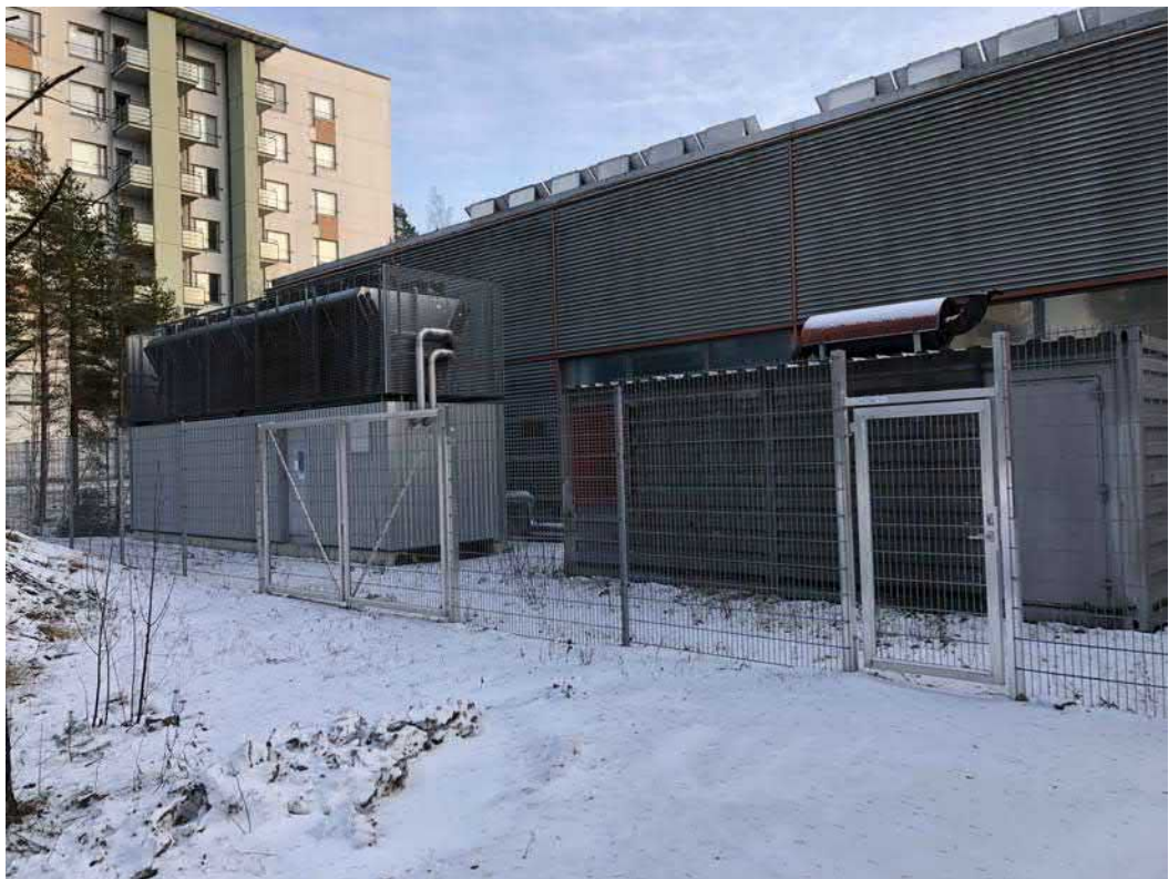
Kuva 29. Sähkötalon pohjoissivun jäähdytys- (vas.) ja varavoimakontti (oik.).
